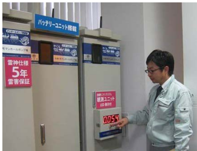
放射線観測ユニットを同社が提供するマンホールポンプ制御盤に取り付けて監視できる
