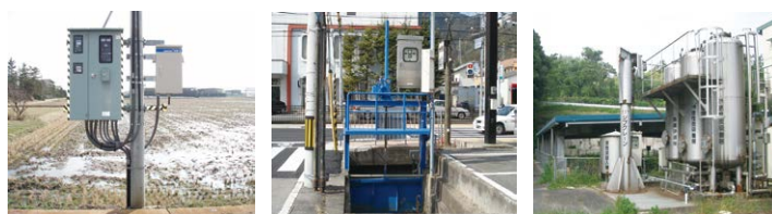
融雪雪管理制御施設
