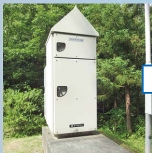
既存施設 W800×H2200×D800
