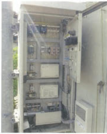
写真-1 旧制御盤
