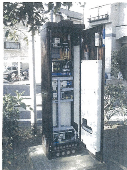
写真－5 制御盤外観（扉開）
