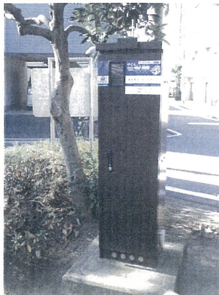
写真－4 制御盤外観
