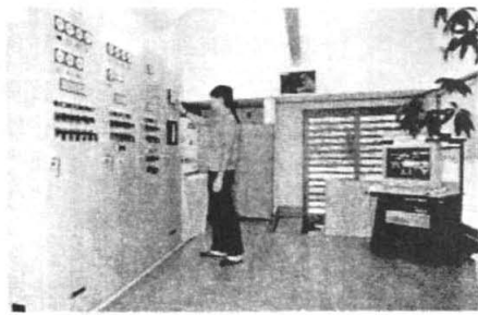
小松電機産業が開発し、松江市に設置した簡易水道施設遠方監視装置の中央監視盤。各施設のデータがデジタル表示される。
