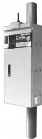
写真 1 マンホールポンプ制御盤
