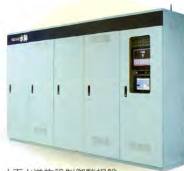
上下水道施設制御監視盤
