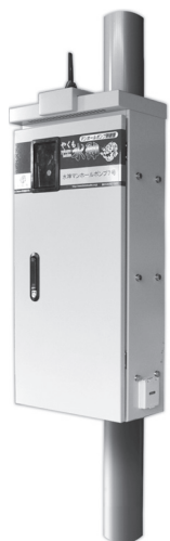
写真7 マンホールポンプ制御盤
