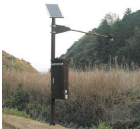
水位・流量観測システム（島根県松江市）
