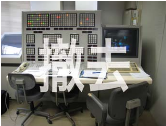
旧中央監視装置
