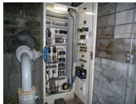
工業用水施設に後付け監視設置
