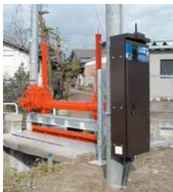
ゲート管理制御システム
