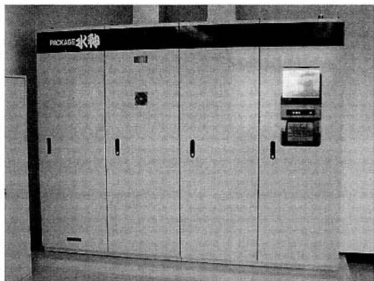
処理施設管理棟に設置された監視制御装置
