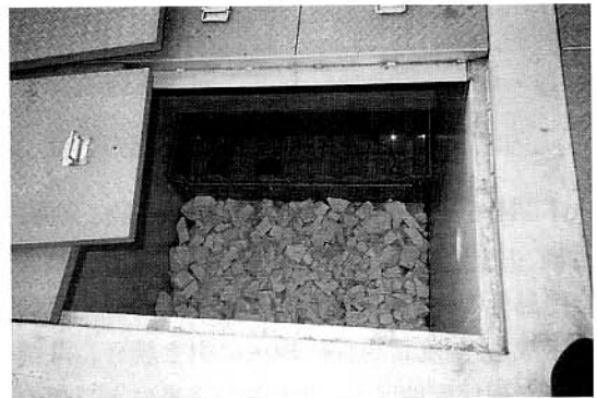
反応槽に充填された脱窒材
