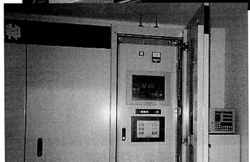
監視制御装置
