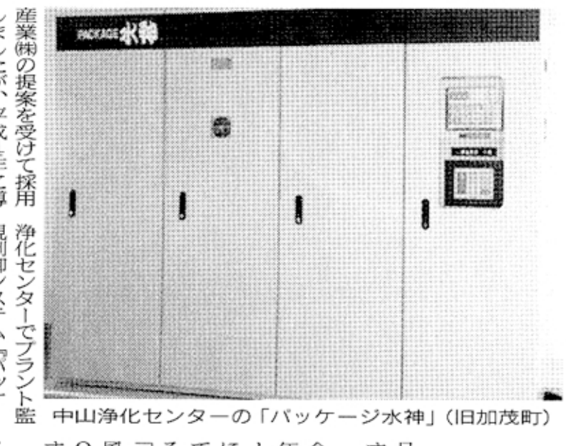
中山浄化センターの「パッケージ水神」(旧加茂町)
