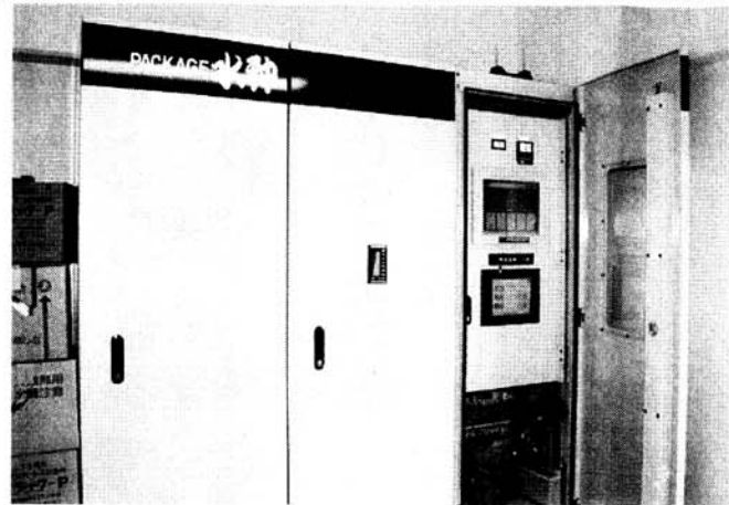
現地設置の監視制御装置
