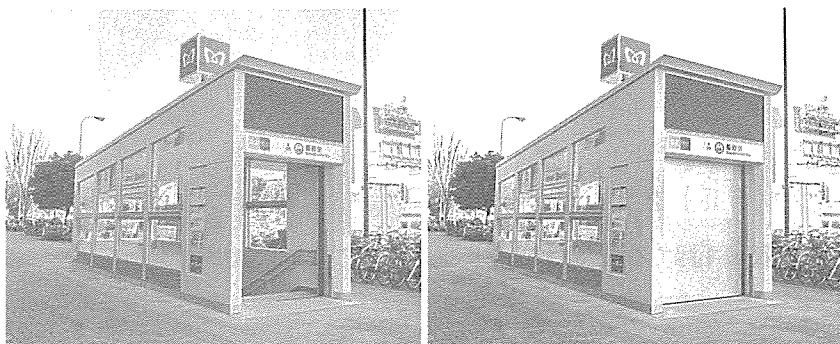
要町駅4番出入口に設置した防水シャッター、(左)全開時、(右)全閉時
